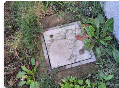
Imagen: Cámara de inspección. Fuente: Elaboración propia.
