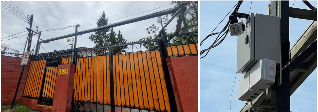
Figura 5.2: Punto de instalación en el lugar de despliegue, Colegio San Agustín, Calle Contra-maestre Micalvi, Ñuñoa, RM.
